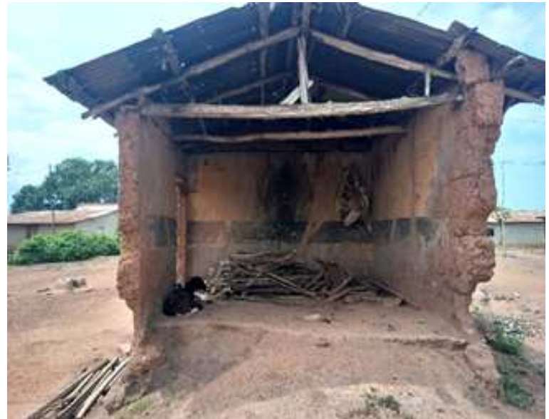
Maison détruite par la pluie
